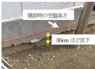
写真-6 抜け上がり現象
