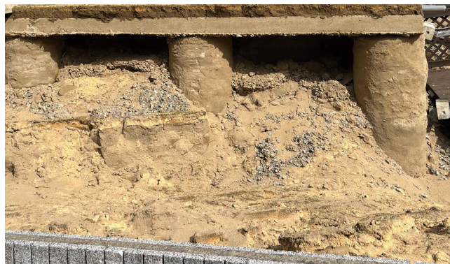
写真-3 液状化被害
